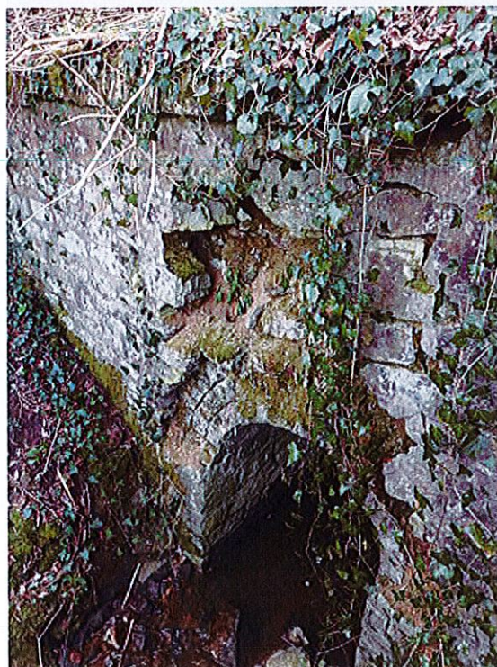
Vue des désordres structurels de la tête aval
